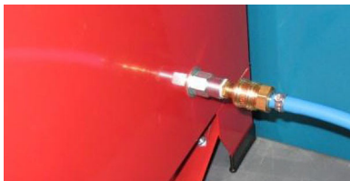
Abb. 10: Anschluss Druckluftleitung SSK1
